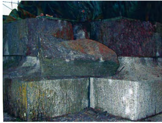
Abb. 17: Schäden am Steinsockel (aus BBL 2003)
